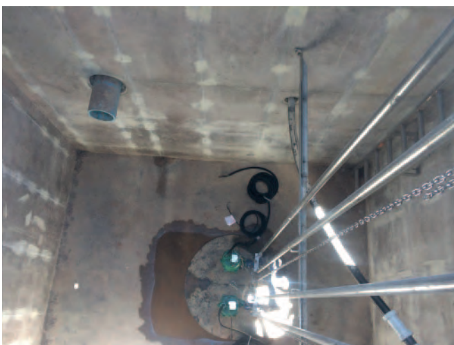
Fig. 7 : vue du dessus dans la nouvelle station de relevage en béton coulé sur place, élément-clé de l'infrastructure d'égout pour l'extension du club exclusif Roaring Fork à Basalt dans l'état américain du Colorado.
