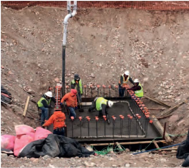
Fig. 5 : une dalle de fondation d'env. 45 cm d'épaisseur est coulée pour la nouvelle station de relevage.
